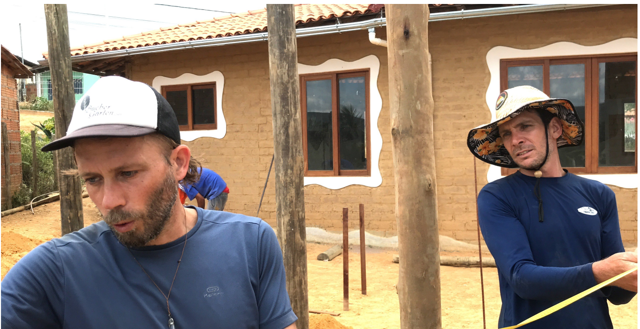
Bau der ‚Arcademia‘: Rico und Stefan messen die Distanz der Holzpfeiler aus.
